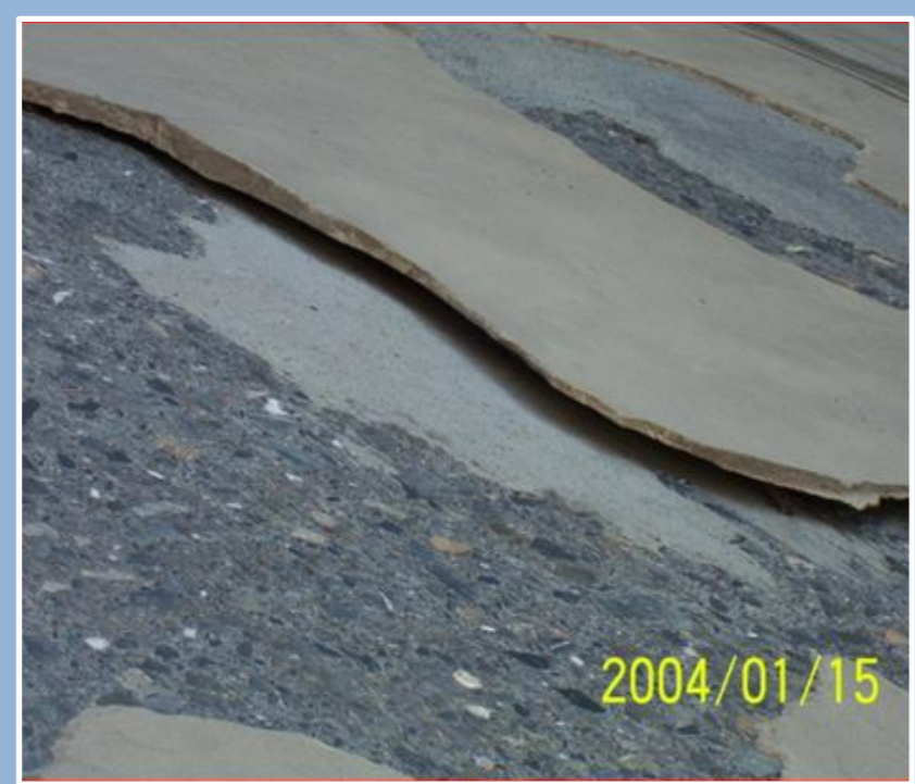
環氧樹脂破壞情形
