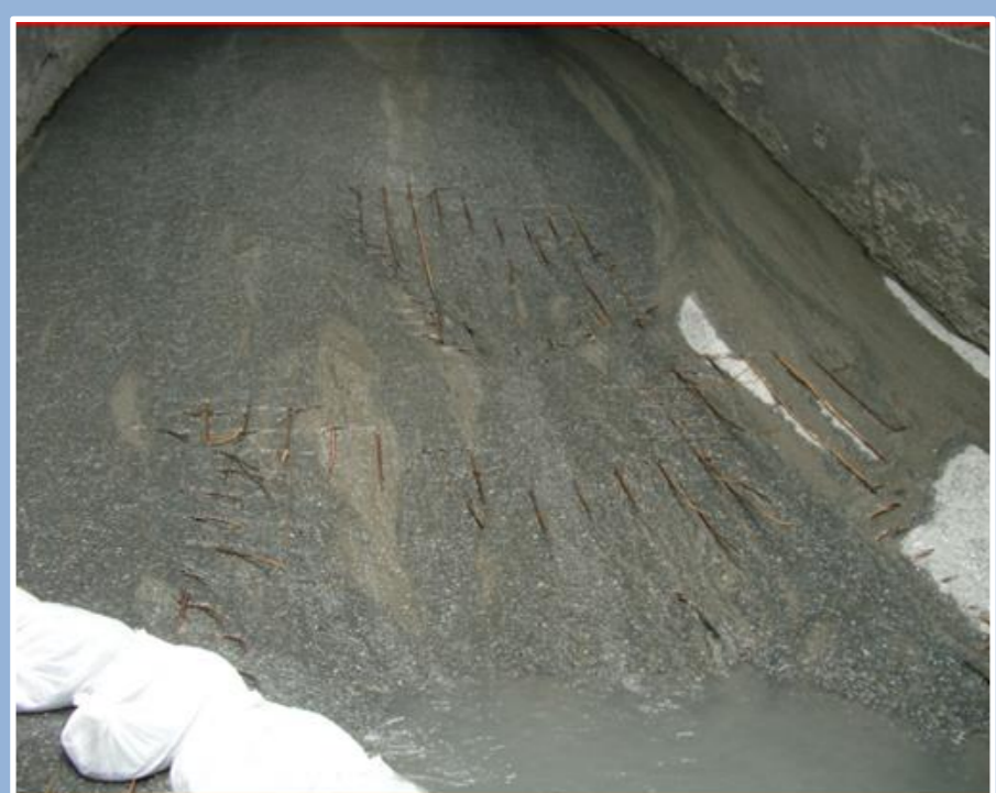
耐磨層磨損沖刷後鋼筋外露
