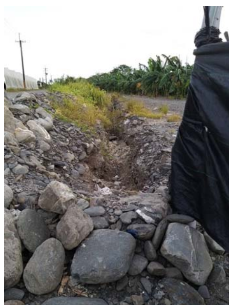
圖 6.園區周遭的排水深溝如人員未注意，極易發生意外
