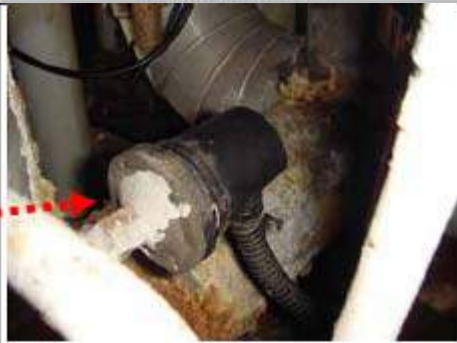
熱感知器未拆解前
