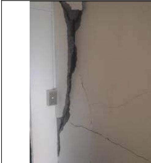
圖 7. 受災後之牆面(此為儀器室之牆壁)
