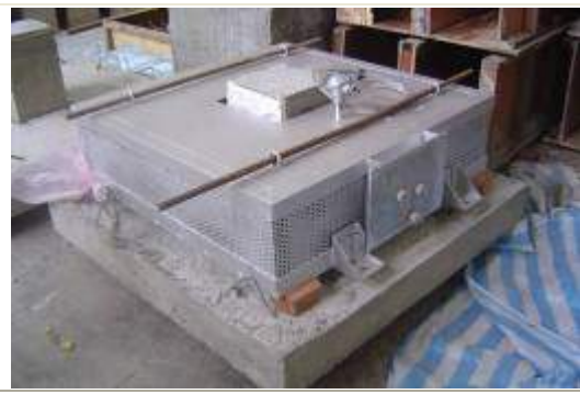
高溫設備宜加警告標示
