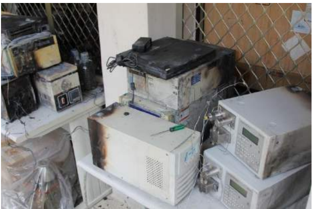
5. 燒毀之儀器設備
