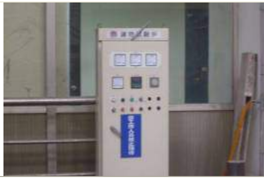
配電盤未上鎖管制
