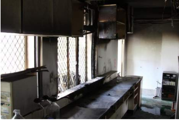
1. 燒毀的區域(實驗桌和吊櫃)
