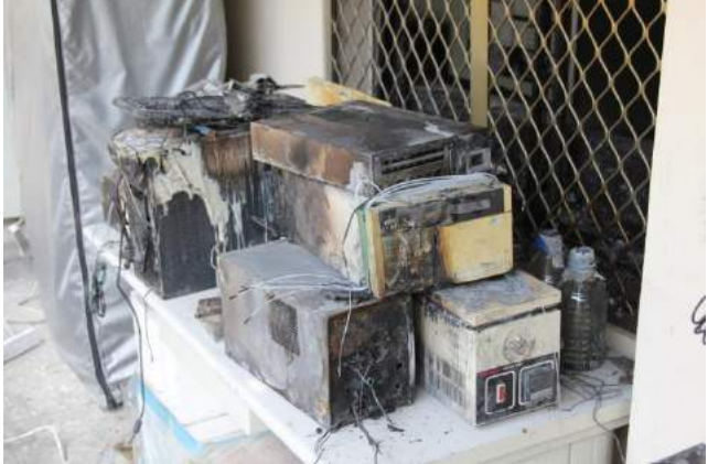
4. 燒毀之儀器設備
