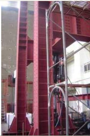
鋼構內置爬梯宜加設安全母鎖
