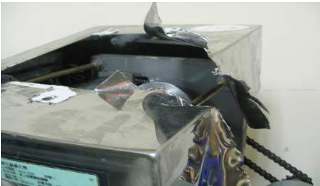
說明：因搶救需要破壞機台外殼
