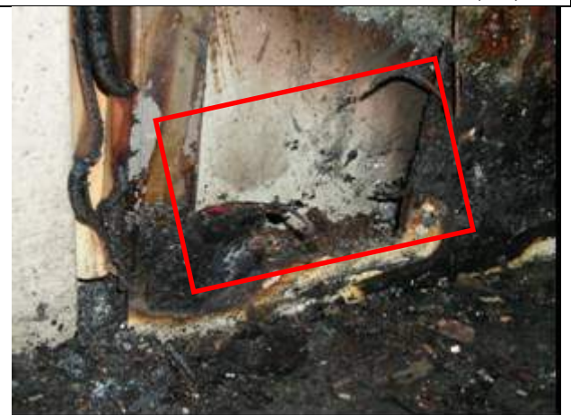
圖 4、於抽氣櫃內加裝之插座燒毀情形
