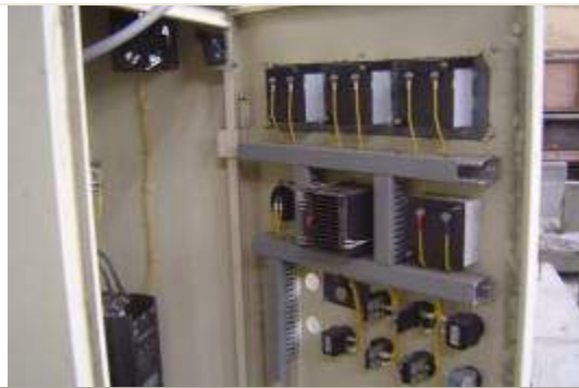
電線接頭並無防止感電裝置
