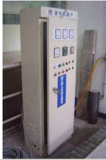
配電盤未上鎖管制
