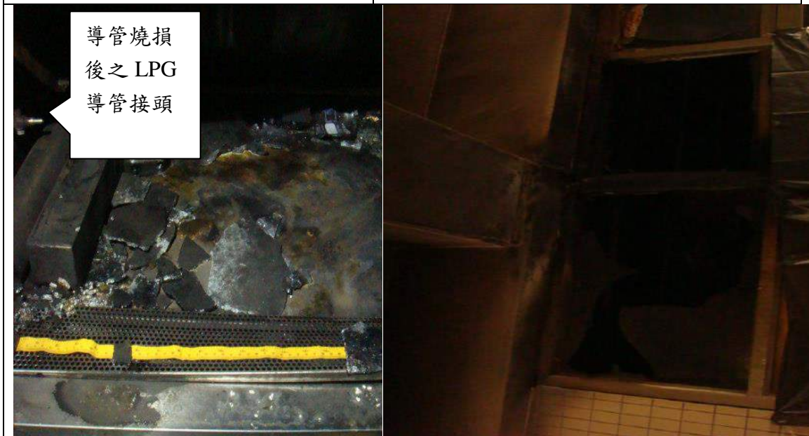
圖 3 疑似起火點(此點為瓦斯導管燒損後自 5 公斤鋼瓶出氣及造成噴焰續燒可能氣體洩漏點)
