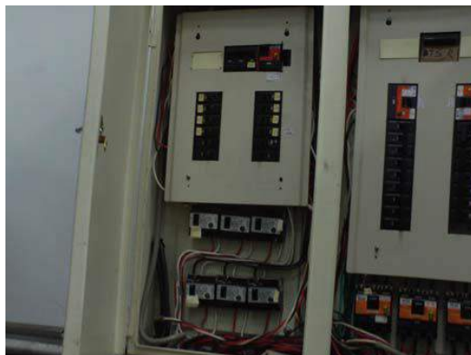
說明：總電源箱未加裝保護蓋板
