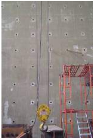
起重機鋼索因鋼樑撞擊而損傷
