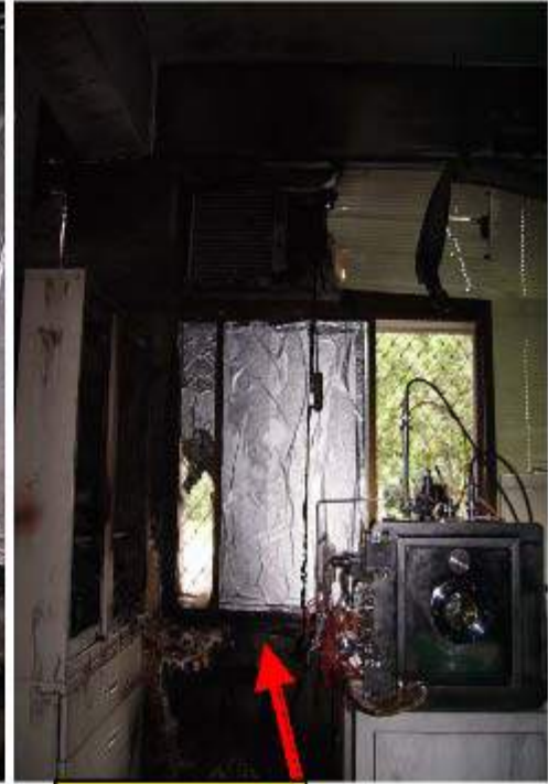
窗戶燒燬情形
