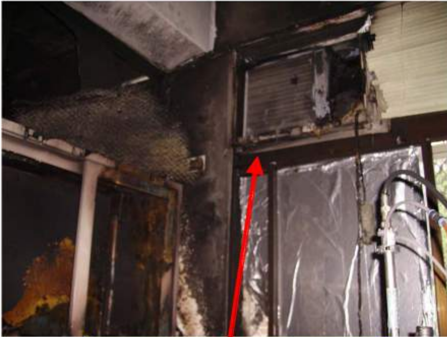
冷氣機及冷氣機下方開關燒燬情形
