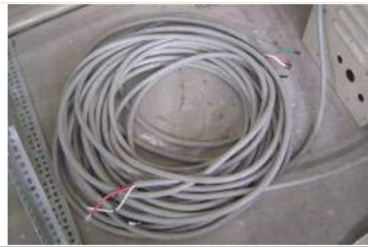
裸線接頭易有感電危害
