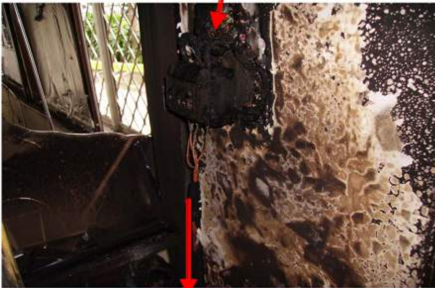
開關下方開關電線燒燬情形
