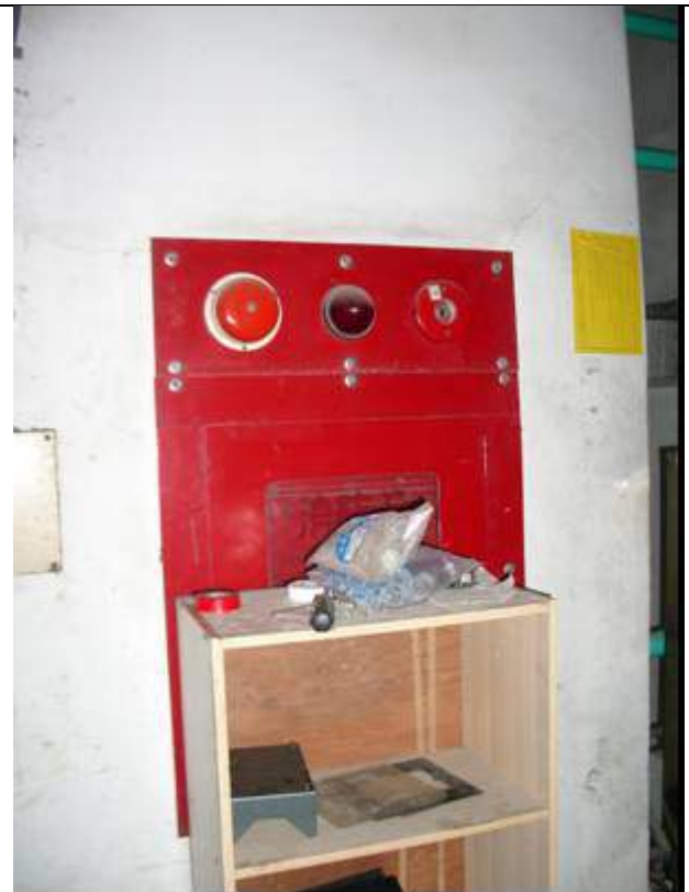
圖 10、置物櫃阻擋走廊消防栓之操作
