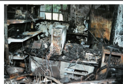
圖 18、電線劣化引起火災
