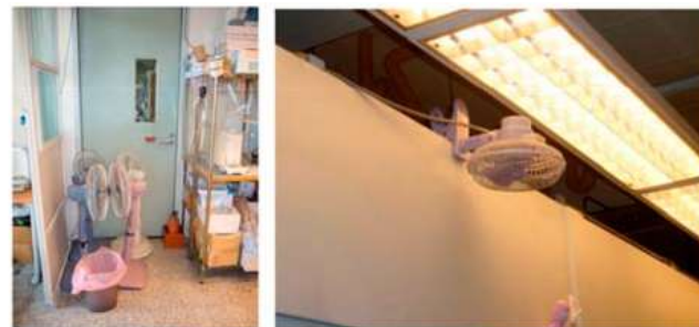
圖十四 由於使用排風櫃，實驗室空調效率較差，較為悶熱。但不應使用電風扇，以免亂流將有毒物質從排風櫃內帶出，影響安全。
