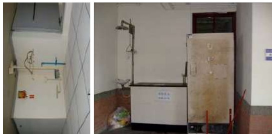
圖十三 (左) 使用單位有維護設備正常與潔淨，及空間不被佔用之責任。(右) 沖眼器、緊急淋浴空間被用最為常見，一旁設置電器時，使用期間將發生漏電風險。
