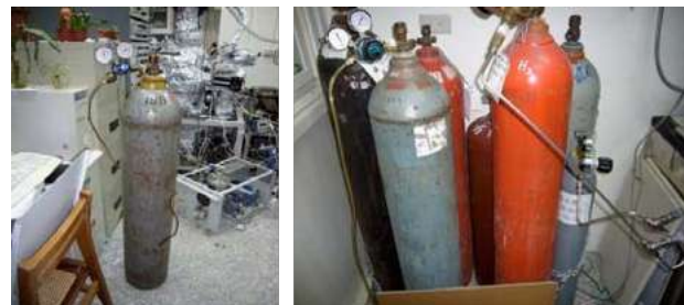
圖十六 常見的鋼瓶管理不當例子，鋼瓶未加固定、各類氣體（其中有氫氣，乙炔等高公共危險性氣體）混處、未與電器設備保持距離。
