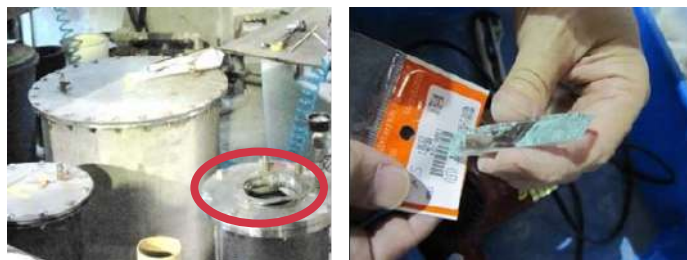
圖二十九 左邊為現場爆裂鋼瓶；右邊為現場爆裂的觀測窗玻璃
