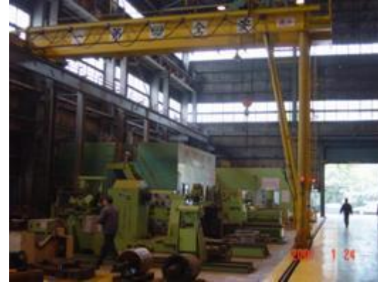
備註：（半門型橋式起重機）吊升荷重 7.5 公噸
