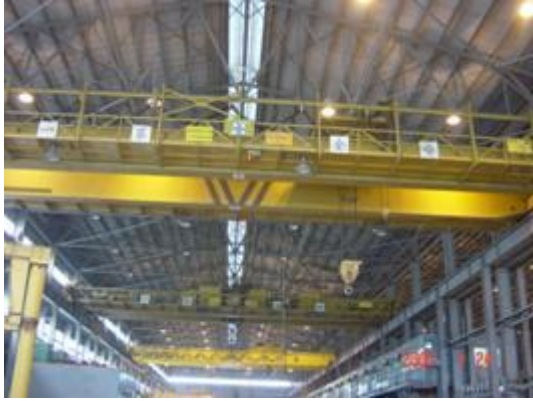
備註：（絞盤吊運車架空移動起重機）吊升荷重 25 公噸
