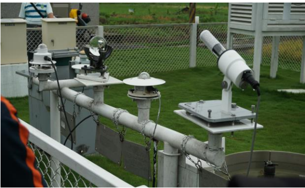
嘉義氣象站儀器設備
