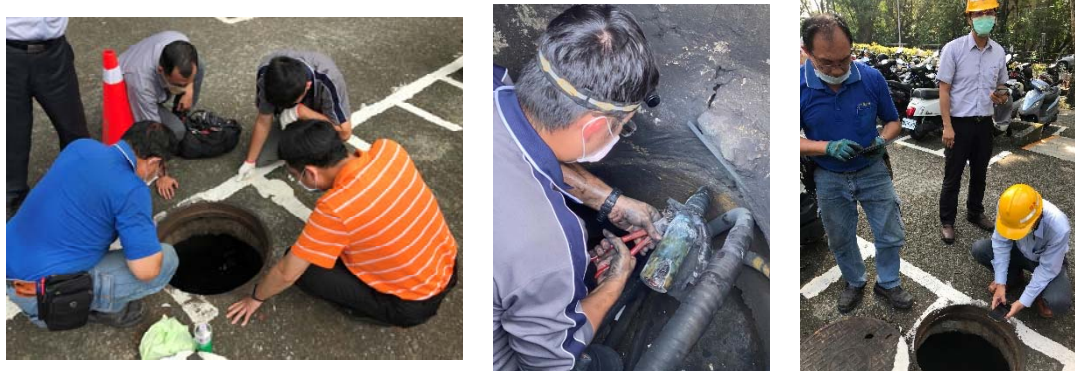
照片 3 本校同仁、機電廠商與台電人員幾乎均於現場待命並預先作業
